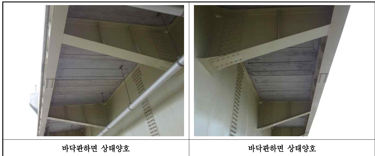
【사진 28.3.3】 바닥판하면 손상현황
