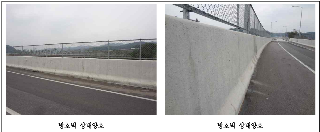
【사진 28.3.22】 방호벽 손상현황
